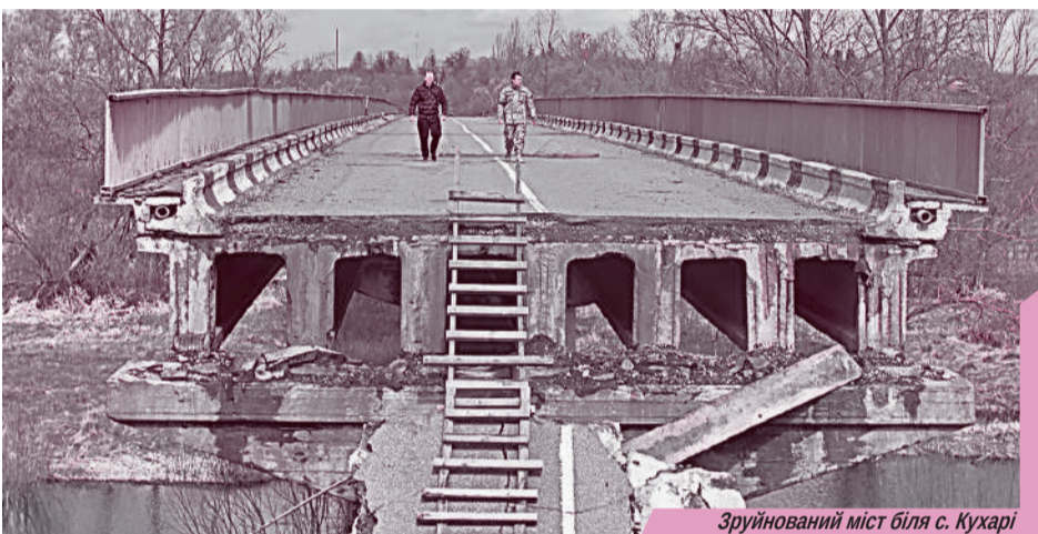
Зруйнований міст біля с. Кухарі
