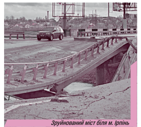
Зруйнований міст біля м. Ірпінь
